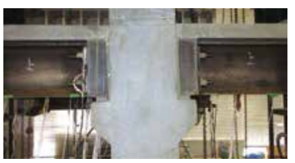
PC-S工法柱梁接合部実験 構造目地部の離間状況(部材角1/50)
