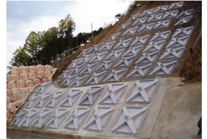
スーパーメタルフレーム 鴨川道路災害復旧工事(千葉県)
